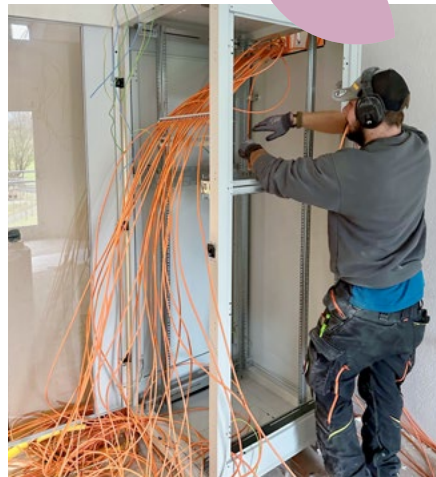
Rack-Verkabelung der UKV- Anschlüsse
